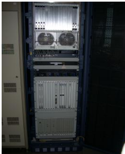
Рисунок 1 Общий вид оборудования с открытой дверью
