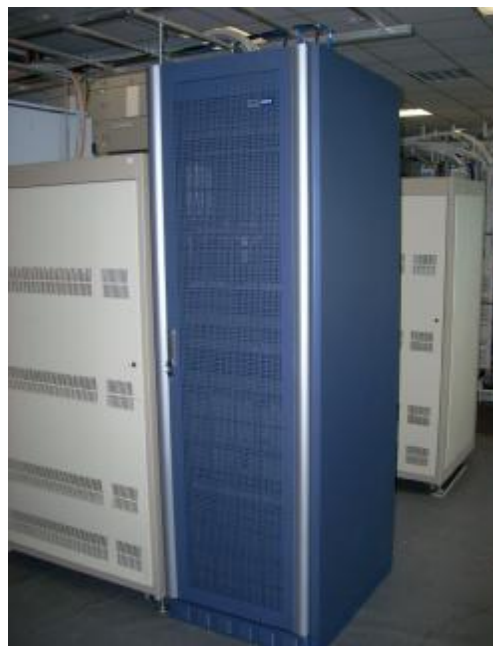
Рисунок 2 Оборудование в стойке с закрытой дверью и замком от несанкционированного доступа
