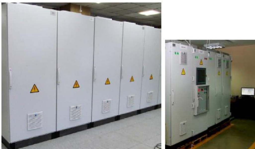
Рисунок 1 - Шкаф ПТК МПСА НПС
