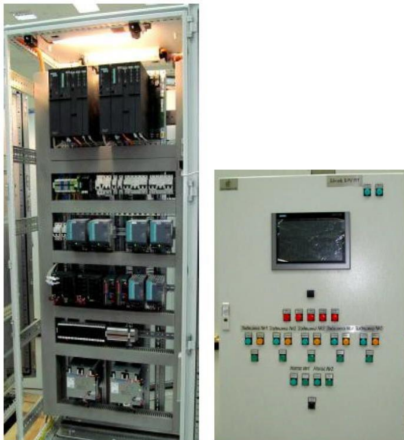
Рисунок 1 - Шкаф ПТК МПСА ПТ
