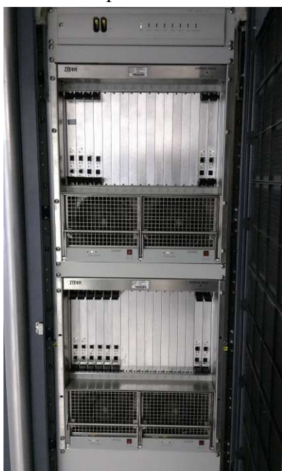
Рисунок 1 - Общий вид оборудования с открытой дверью
