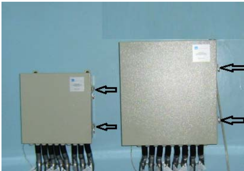
Рисунок 1 - Внешний вид компонентов АСОК ГТС МГУ Шкаф мультиплексоров (слева), шкаф ЛКЦ (справа). Места пломбирования для защиты от несанкционированного доступа к элементам конструкции указаны стрелками.
