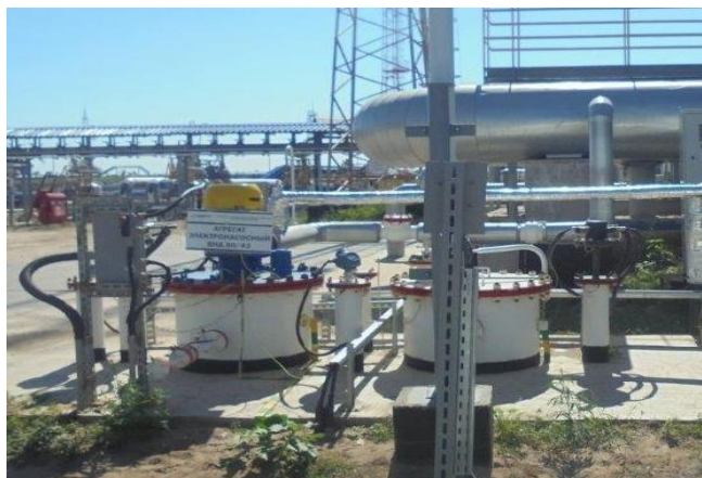
Рисунок 1 - Общий вид места установки резервуара РГС-12,5 № 59040
