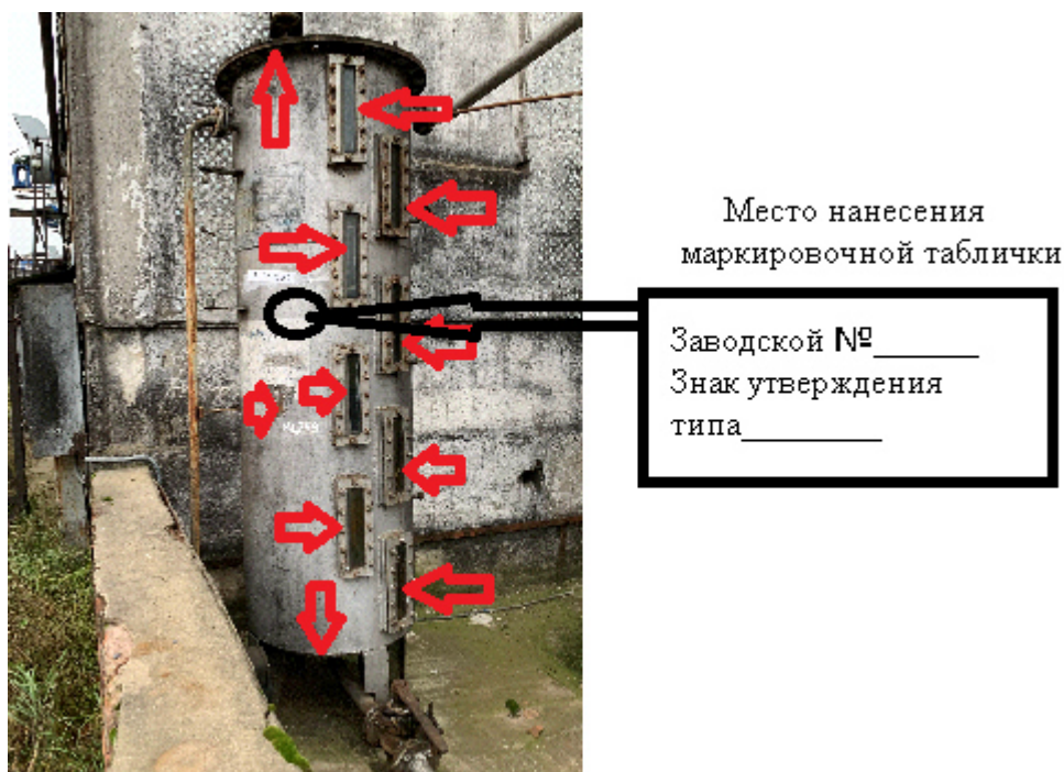
Рисунок 12 – Схема пломбировки мерника МТВ-1 зав. № 11 от несанкционированного доступа, обозначение места нанесения знака поверки, заводского номера и знака утверждения типа
