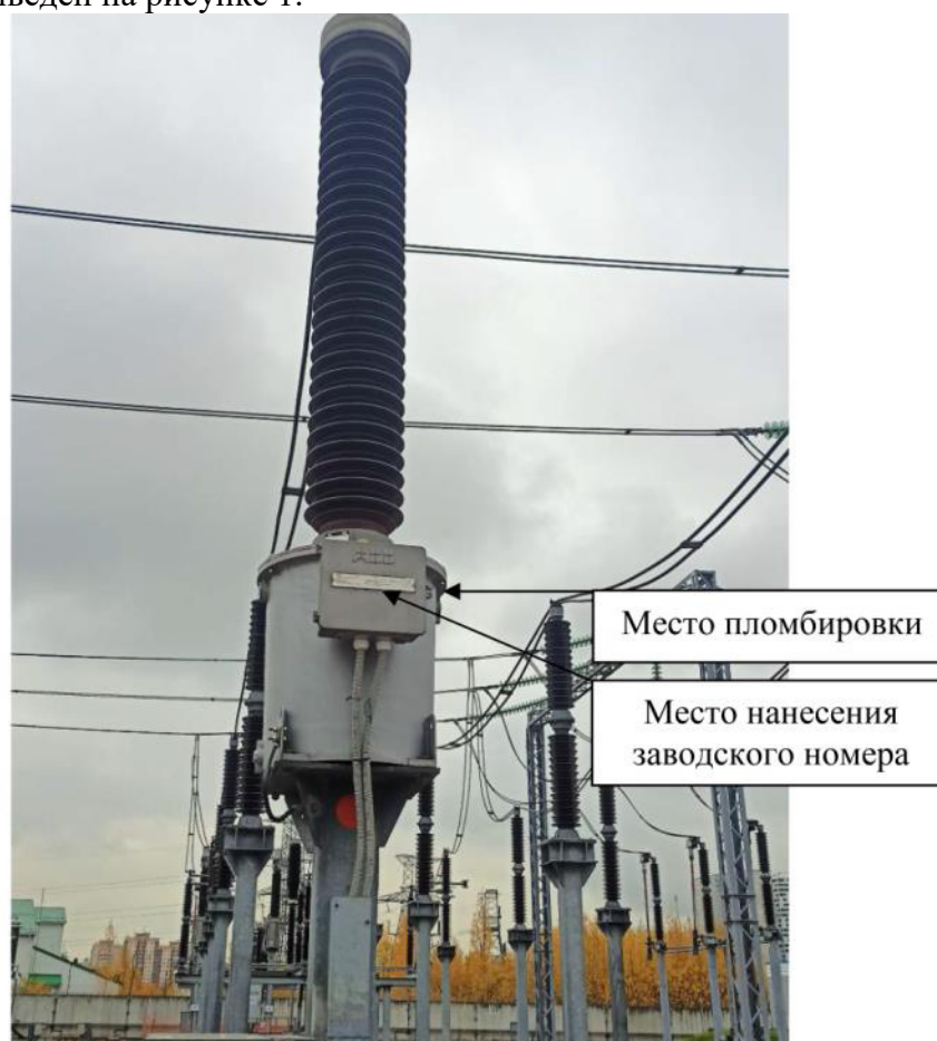
Рисунок 1 – Общий вид средства измерений с указанием места пломбировки, места нанесения заводского номера
