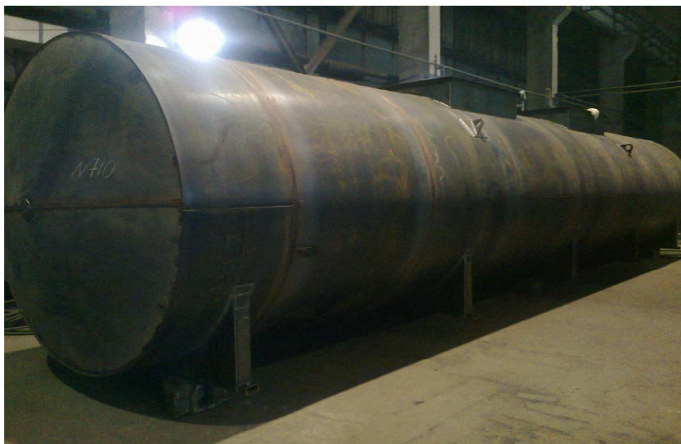
Рисунок 1 - Общий вид резервуара стального горизонтального цилиндрического 2РТ
