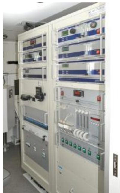
Рис. 2. Стойка газоаналитическая с оборудованием.
