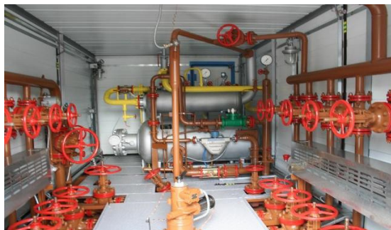
Рисунок 4 - Внешний вид оборудования БТ многоскважинной установки
