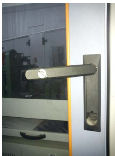
Рисунок 4 – Внешний вид замка на дверце электромонтажной стойки
