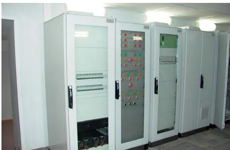
Рис. 3. Шкафы ИБП, БРУ, ШВП, ШПП, УСО ЦСУ
