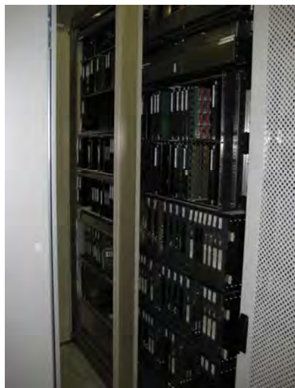
Рисунок 1- Общий вид оборудования с открытой дверью
