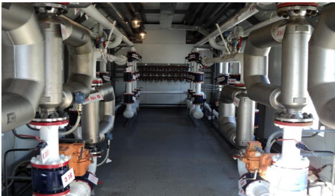
Фото 1 Общий вид СИКН
