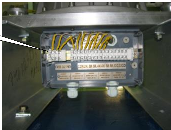
Рисунок 2. Клеммная коробка трансформатора
