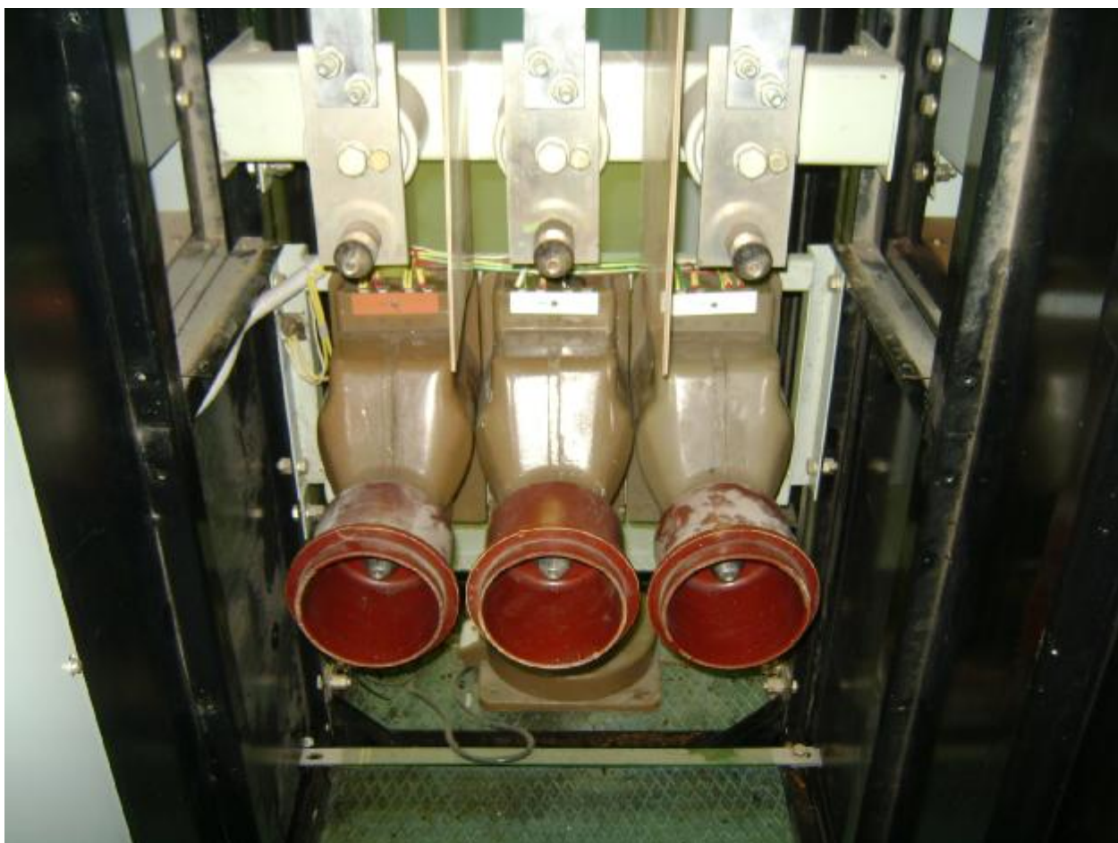
Рисунок 1 – Внешний вид трансформаторов
