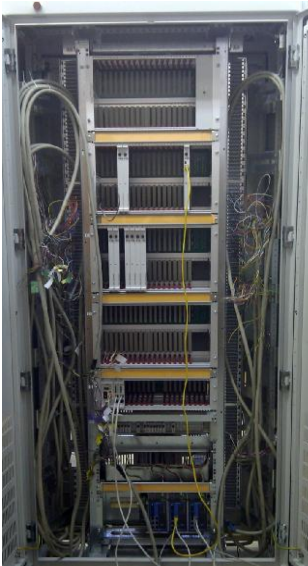
Рис. 2 – Приборная стойка с установленными модулями
