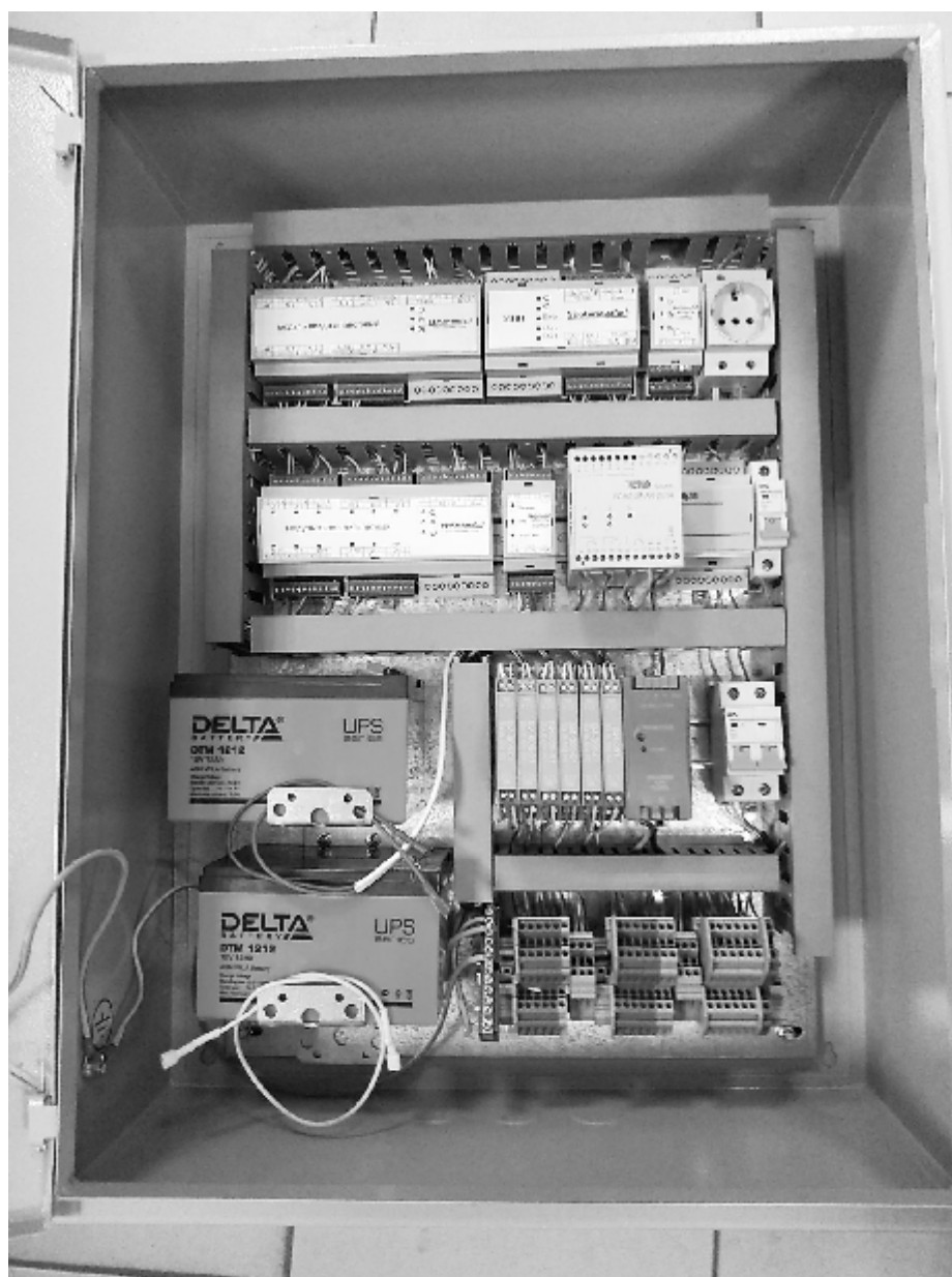
в) шкаф телеизмерений и телесигнализаций
