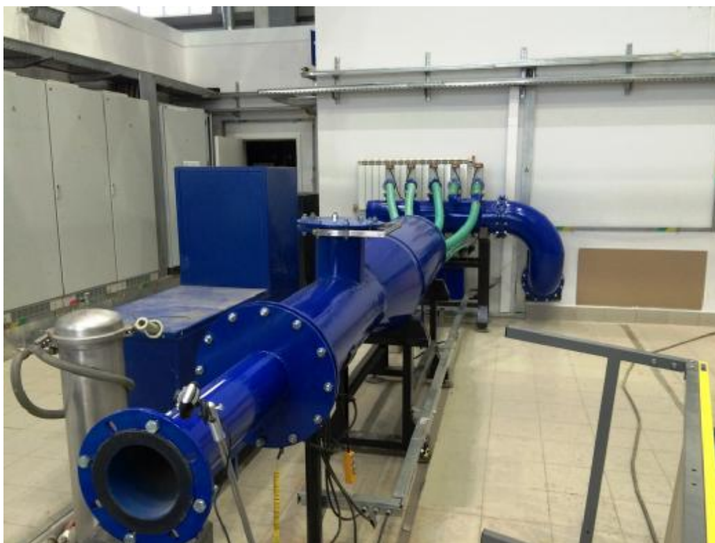
Рисунок 1 – общий вид установки
