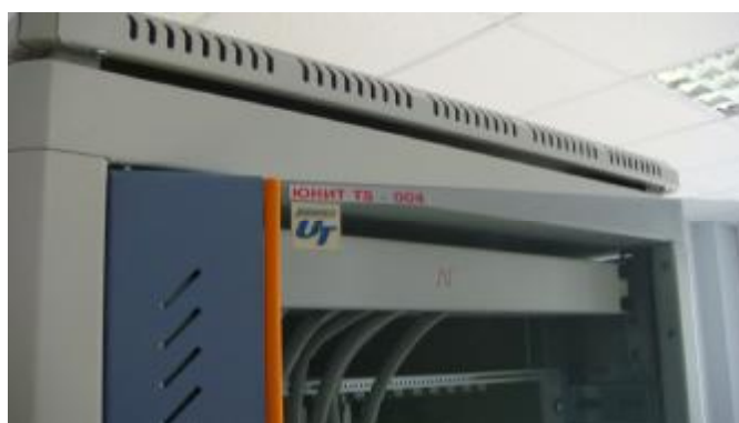
Рисунок 2 - Общий вид верхней части оборудования с этикеткой на двери
