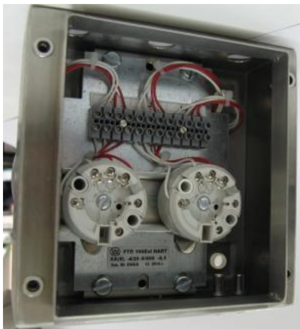
Рис.1 - ТП со снятой крышкой соединительной коробки
