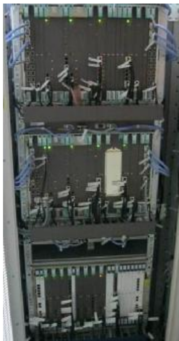
Рисунок 1 - Общий вид оборудования с открытой дверью
