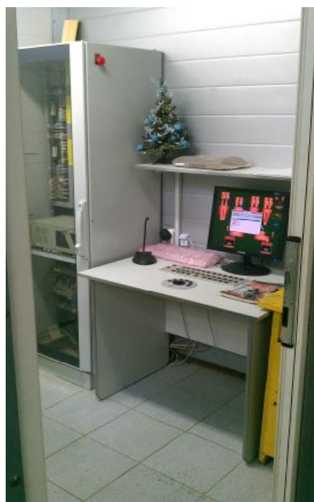
Системная стойка и рабочее место оператора
