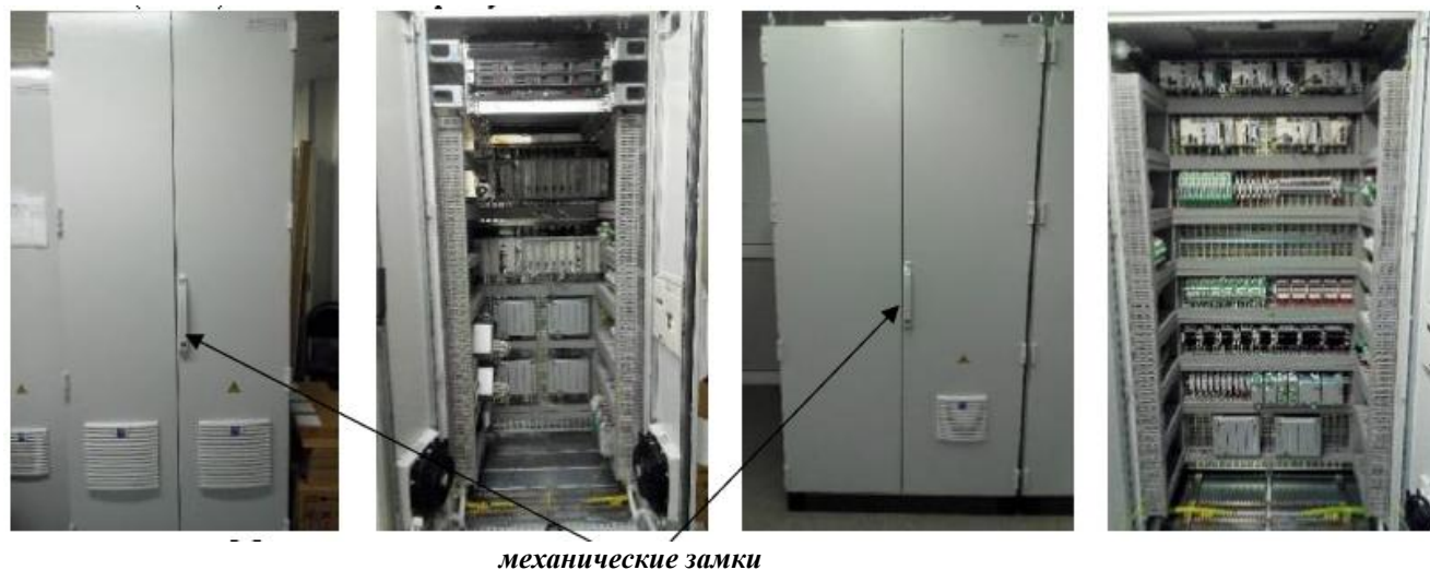
Рисунок 1 - Внешний вид шкафов комплекса
