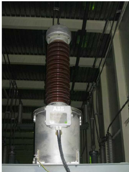
Рисунок 1 - Общий вид трансформаторов напряжения
