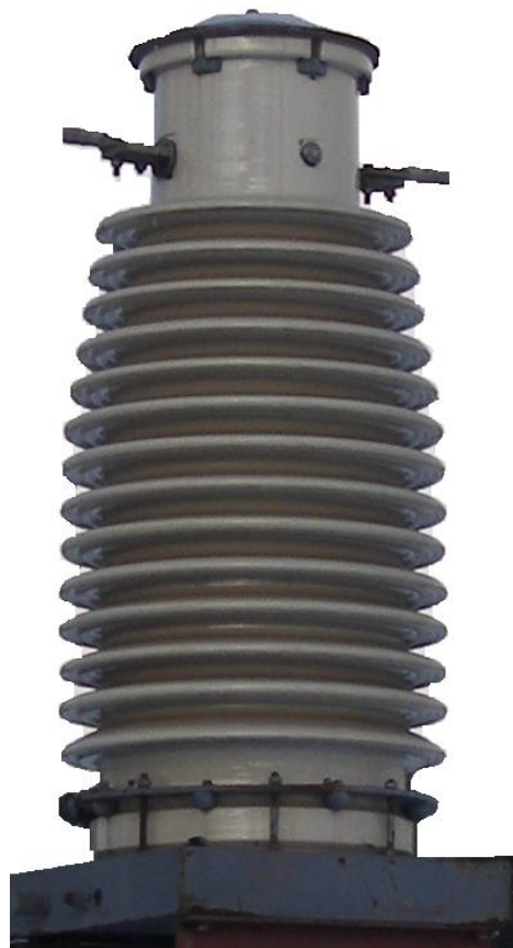
Рисунок 1 - Общий вид трансформаторов тока
