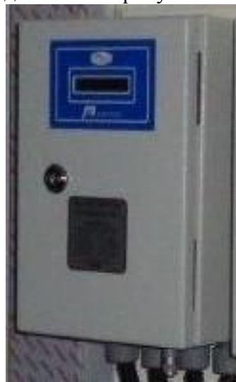
а) вычислитель, установленный в шкафу
