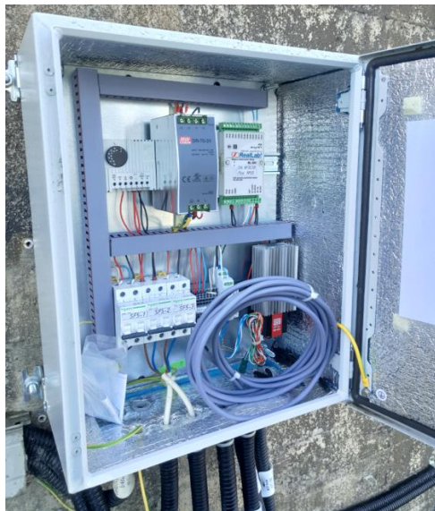
Рисунок 1 - Общий вид интеграционного шкафа
