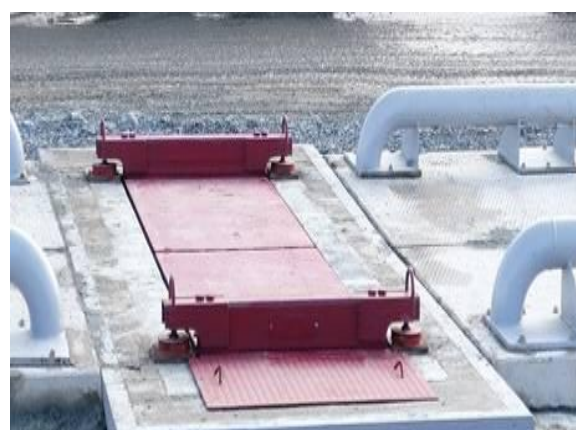
Исполнение ГПУ над поверхностью
