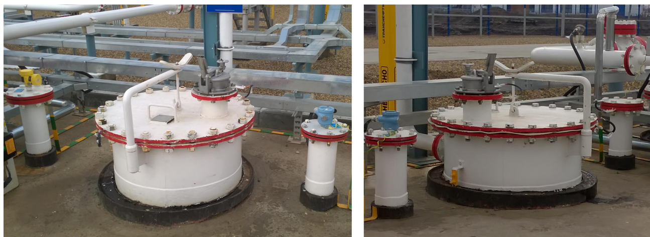
Рисунок 1 - Общий вид места установки резервуаров стальных горизонтальных цилиндрических РГС-16 зав. №№ 39, 40
