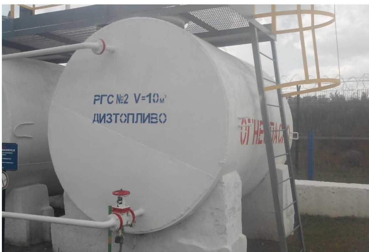
Рисунок 4 - Общий вид резервуара РГС-10 № 4 (НПС «Суходольная»)
