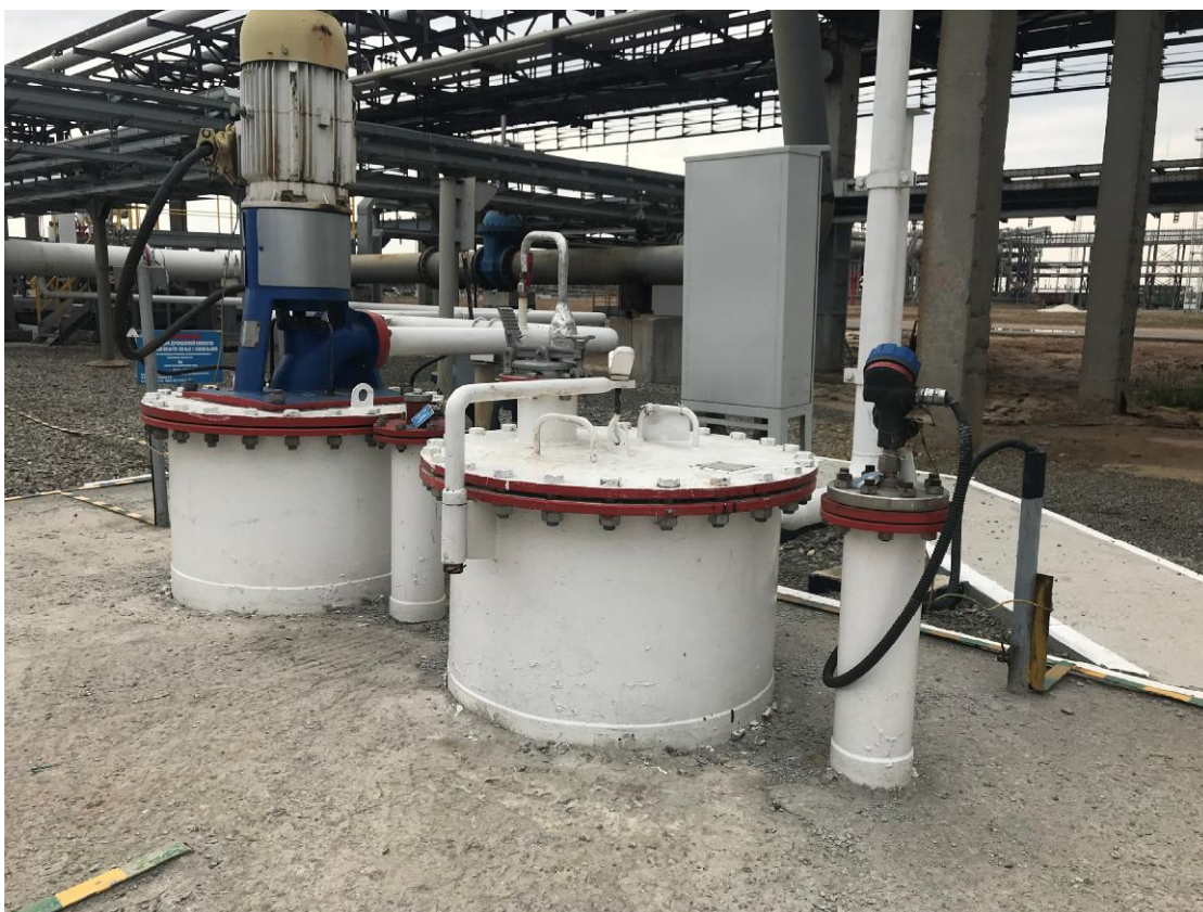
Рисунок 1 - Общий вид места установки резервуара
