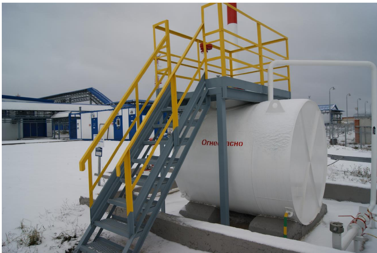
Рисунок 1 - Общий вид резервуаров стальных горизонтальных цилиндрических РГС-5
