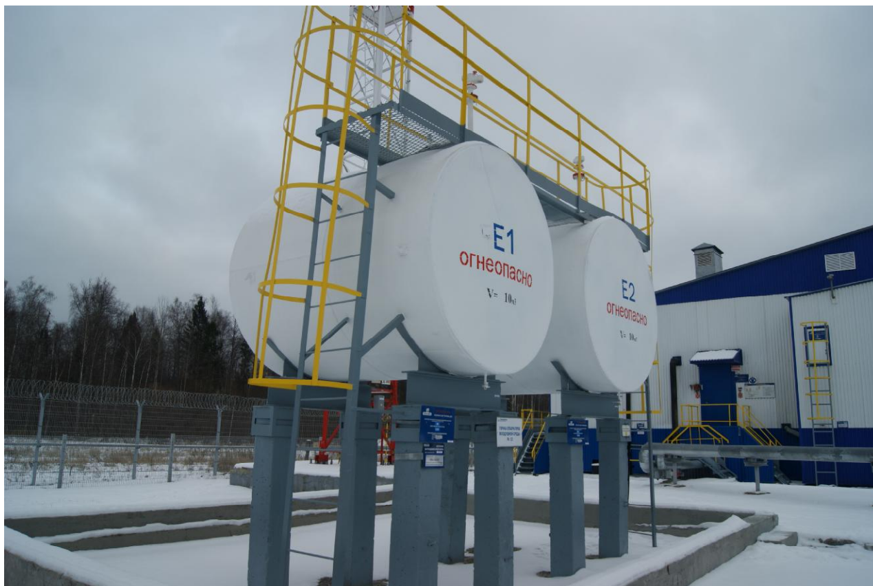
Рисунок 2 - Общий вид резервуаров стальных горизонтальных цилиндрических РГС-10
