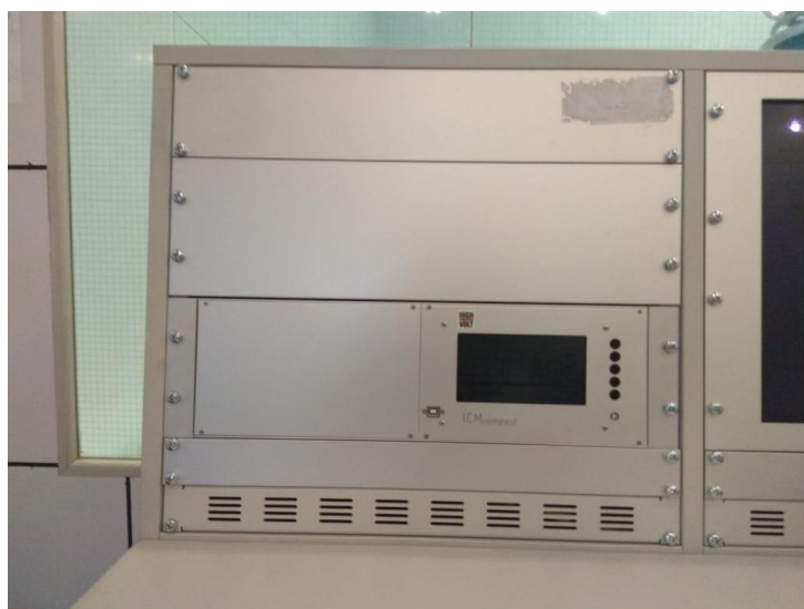
Рисунок 2 – Общий вид измерителя ICMcompact, смонтированного в стойку
