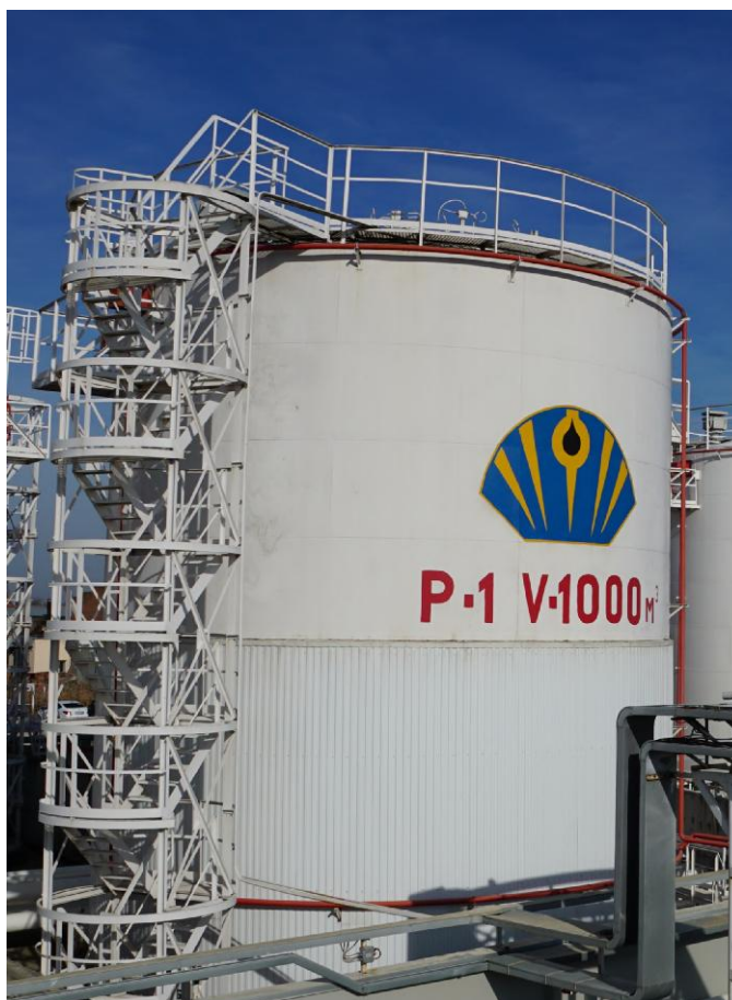
Рисунок 1 - Общий вид резервуара вертикального стального РВС-1000
