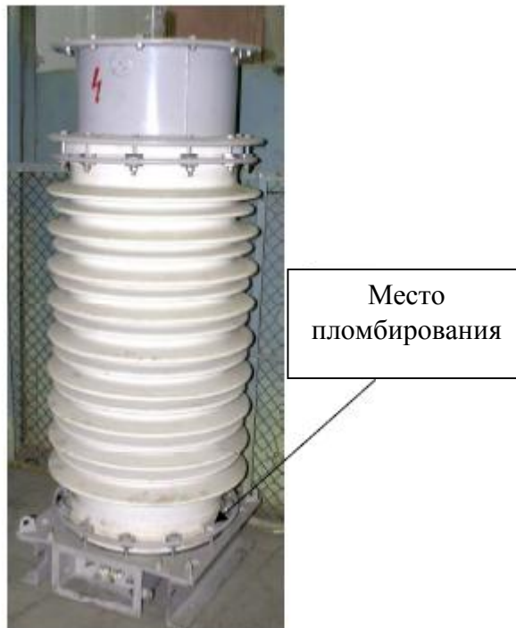
Рисунок 1 – Общий вид трансформаторов напряжения НКФ-110-57У1 с указанием мест пломбирования
