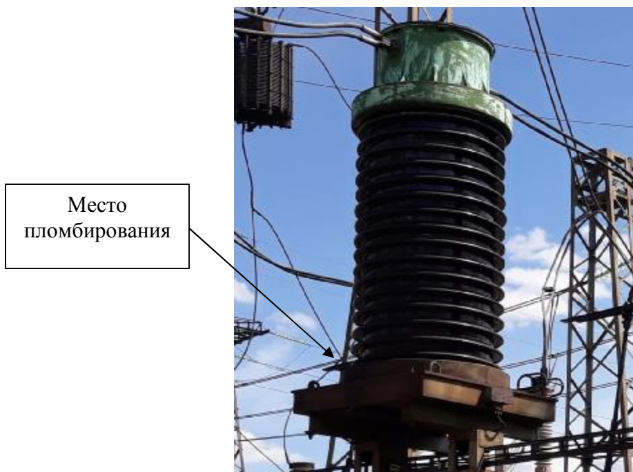
Рисунок 1 - Общий вид трансформаторов с обозначением места пломбирования
