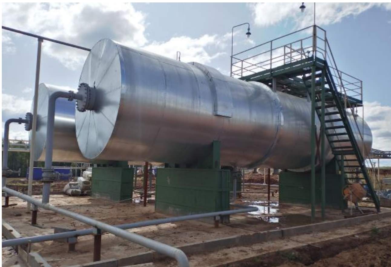
Рисунок 1 – Общий вид резервуаров РГС-100
