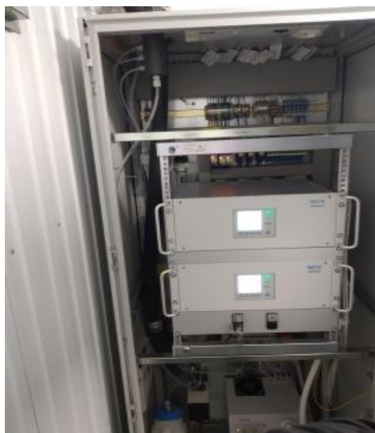
Рисунок 2 – Вид внутри блок-контейнера
