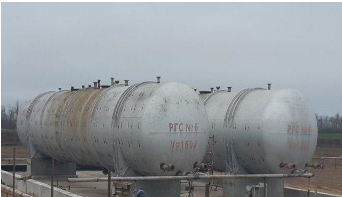
Рисунок 1 – Резервуары горизонтальные стальные РГС-160
