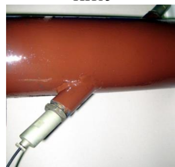
ПП расхода с ПЭП, установленными в прямолинейном участке трубопровода
