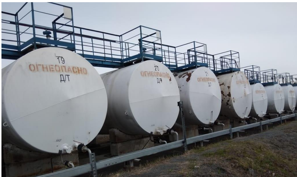
Рисунок 1 – Общий вид резервуаров РГС-75
