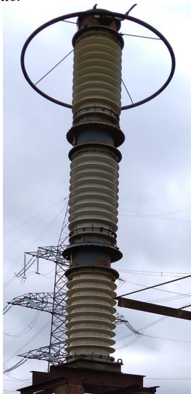
Рисунок 1 – Общий вид трансформаторов напряжения НКФ-330-73У1
