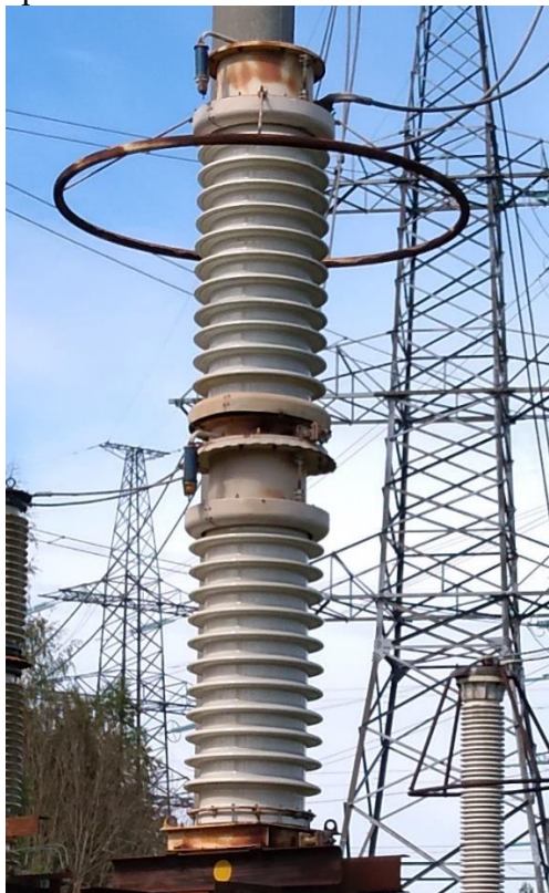
Рисунок 1 – Общий вид трансформаторов напряжения НКФ-М-330 АУ1
