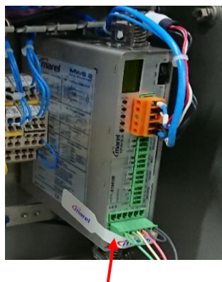
Разъем соединения сигнального кабеля датчика к АЦП
