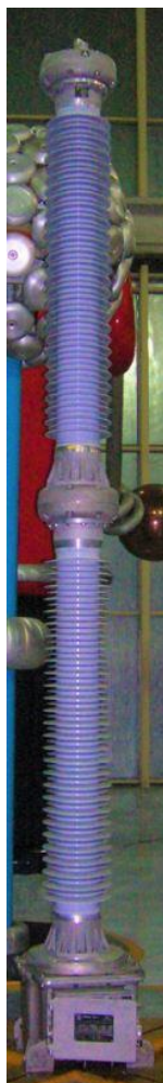
Рисунок 1 - Общий вид трансформаторов
