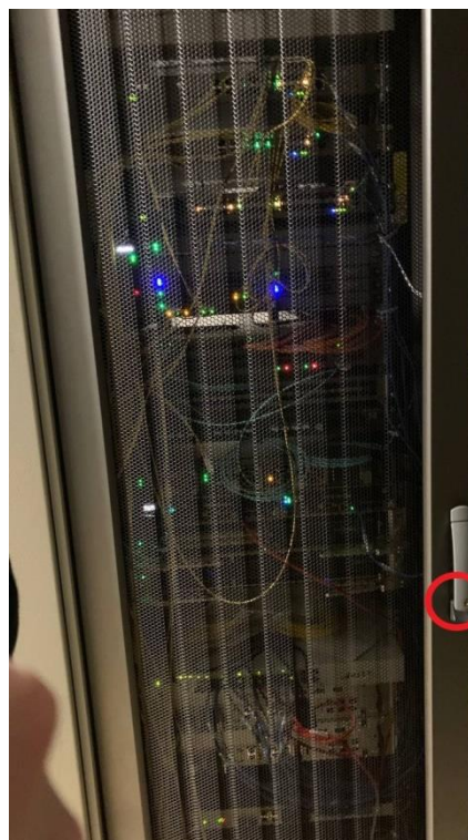
Рисунок 2 - Место блокировки от несанкционированного доступа к стойке с оборудованием
