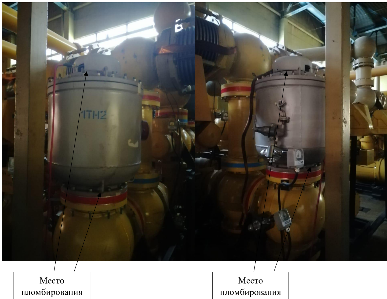
Рисунок 1 - Общий вид трансформатора напряжения типа ЗНОГ-110-79-У3 и обозначение места пломбировки от несанкционированного доступа
