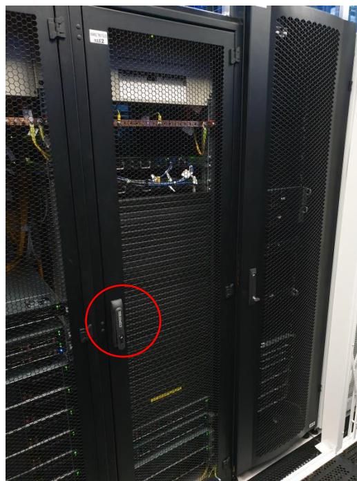
Рисунок 2 – Место блокировки от несанкционированного доступа к стойке с оборудованием (выделено)
